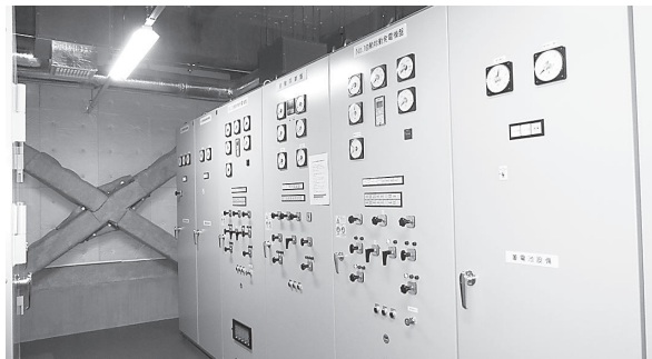
非常用発電設備
