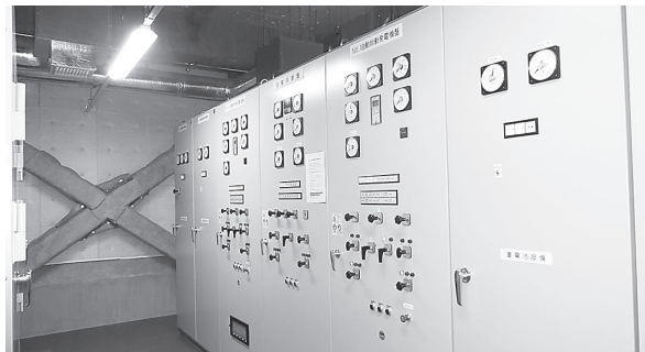
非常用発電設備
